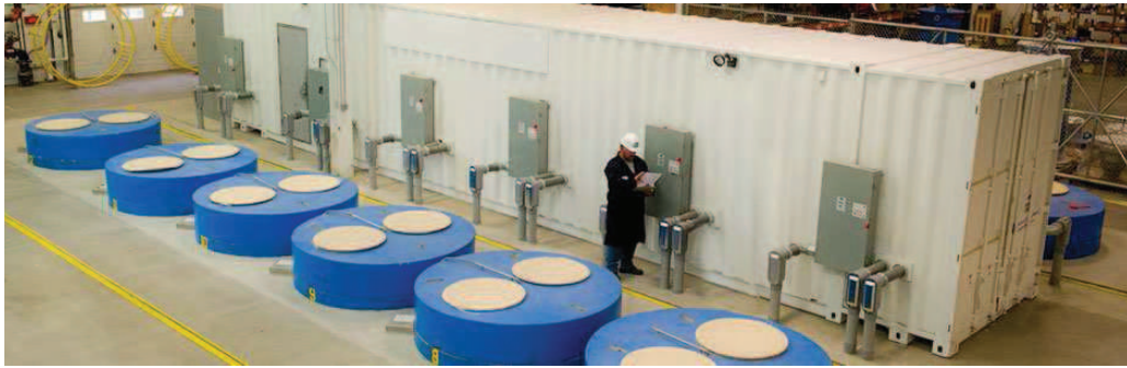
Figure III-11 : Centrale inertielle de Beacon Power [32]
