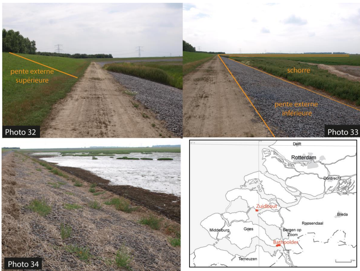
Photos 32 à 34 : revêtement des pentes externes de digues avec Elastocoast à Bathpolder. Source : S. Gueben-Venièrre, juillet 2010.
