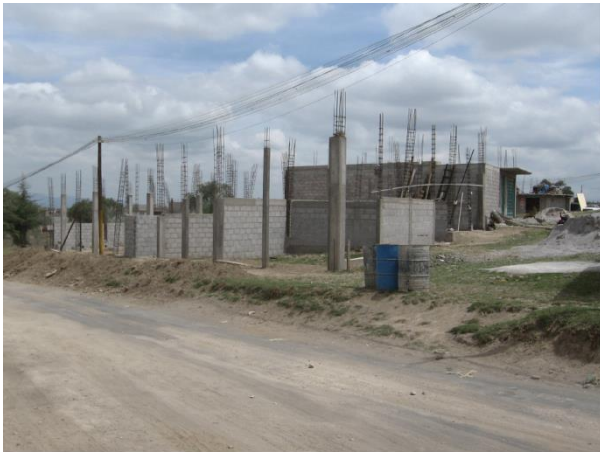
Photo 8.1. Lomas San Sebastián, La Paz, Etat de México, 2010. Fondations de maisons en construction au sein d'un "projet de logement" pour de nouveaux acquéreurs, résidant encore ailleurs.
