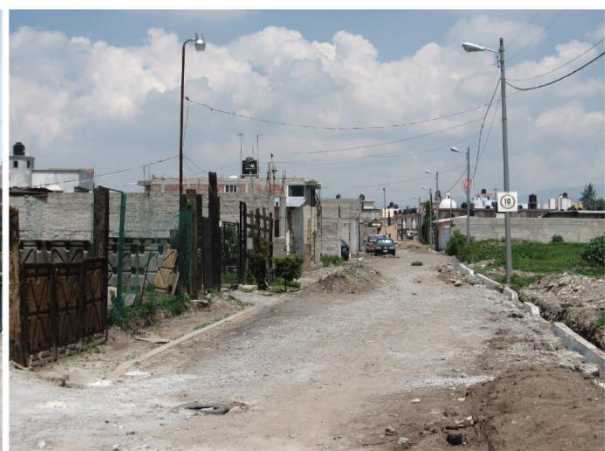
Photo 6.14. Santa María Ixtacalco, Cuautitlán, Etat de México [2011] Pose de l'adduction d'eau et des égouts et construction des trottoirs
