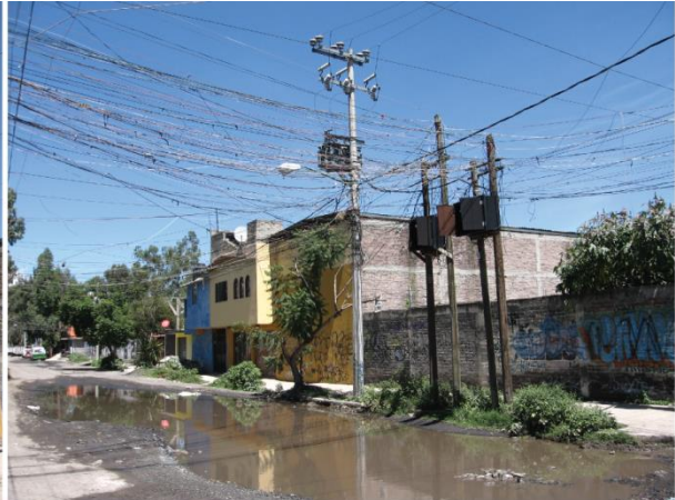
Photo 8.12. Ampliación La Conchita, Tláhuac, DF, 2011. Réseaux électriques légaux et pirates : le transformateur et le réseau avec pylônes en béton alimentent le nord de la colonie, tandis que les câbles précaires alimentent une à une les maisons du sud. Malgré l'apparence de précarité, les câblages ont été entièrement refaits début 2011.
