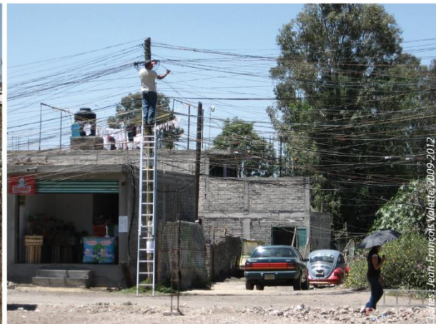
Photo 6.8. Ampliación La Conchita, Tláhuac, DF [2010] Pose et réparation de câbles précaires et privés pour l'alimentation électrique d'une maison du quartier illégal
