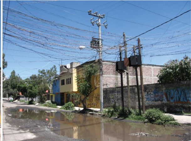
Photo 8.12. Ampliación La Conchita, Tláhuac, DF, 2011. Réseaux électriques légaux et pirates : le transformateur et le réseau avec pylônes en béton alimentent le nord de la colonie, tandis que les câbles précaires alimentent une à une les maisons du sud. Malgré l'apparence de précarité, les câblages ont été entièrement refaits début 2011.
