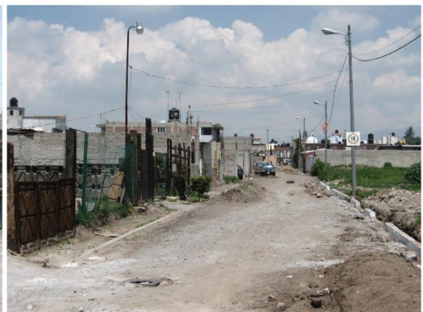
Photo 6.14. Santa Maria Ixtacalco, Cuautitlán, Etat de México [2011] Pose de l'adduction d'eau et des égouts et construction des trottoirs
