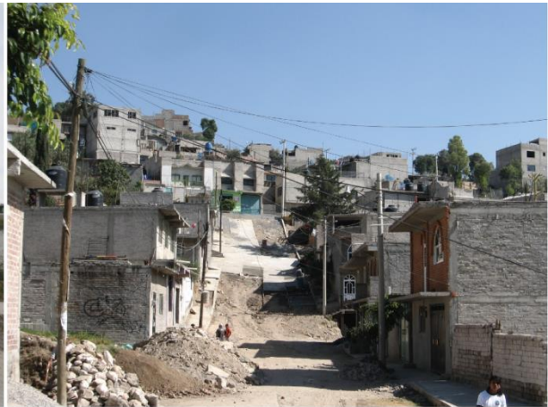
Photo 10.8. Travaux de construction des trottoirs et de revêtement des rues à Ampliación Jorge Jiménez Cantú, La Paz, Etat de Mexico [2010]
