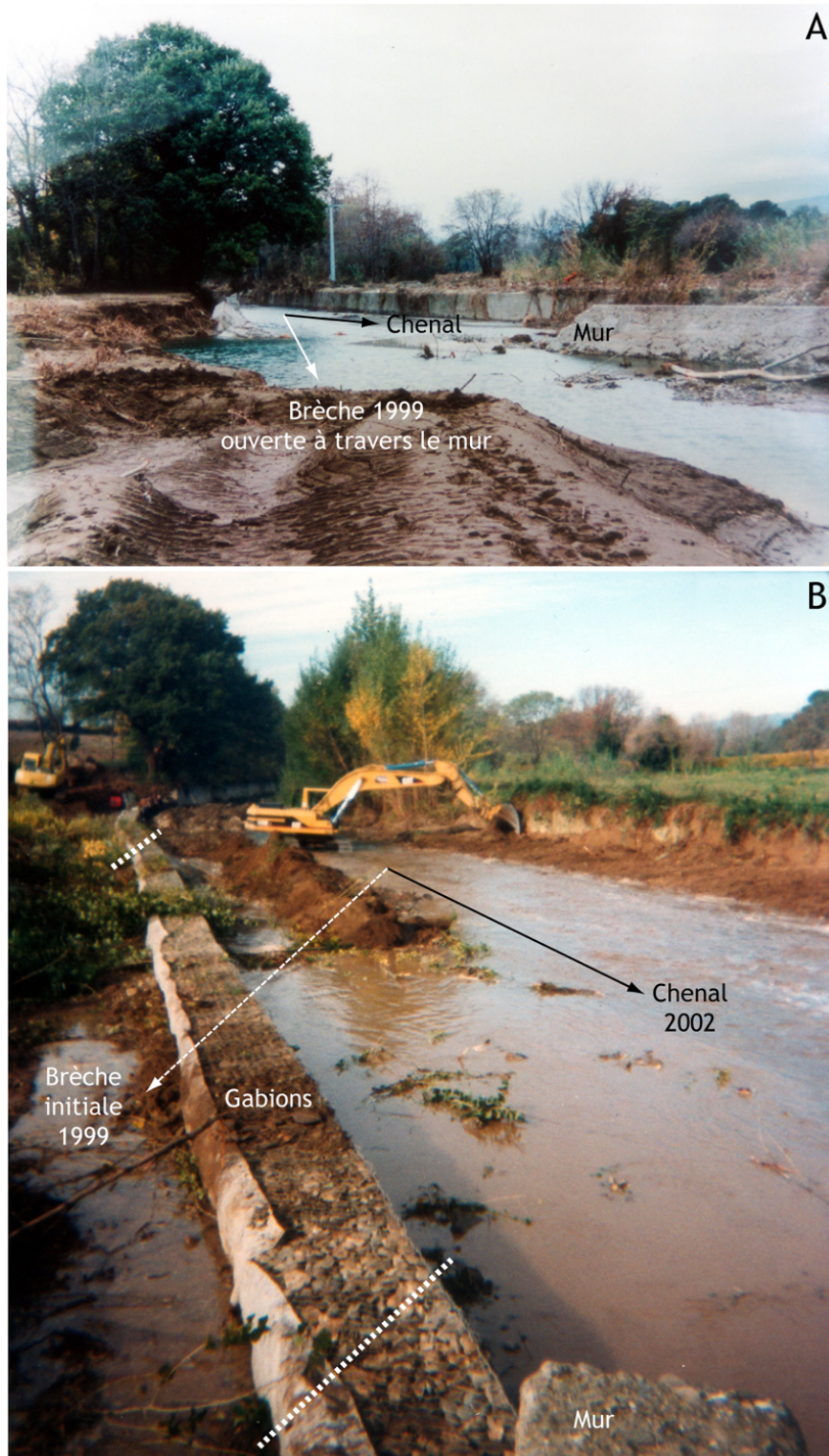
Figure 8.33 – Impacts hydromorphologiques et restauration du chenal de l'Argent-Double en aval du Domaine Pautard (Peyriac-Minervois amont). A : Brèche ouverte en rive droite, liée à une capacité du chenal insuffisante pour évacuer les flux de la crue de novembre 1999 (cliché A. et D. Baudouy, 1999). B : Restauration du chenal à qui l'on redonne une capacité identique à celle qu'il avait avant la crue de 1999 (cliché A. et D. Baudouy, 2002).
