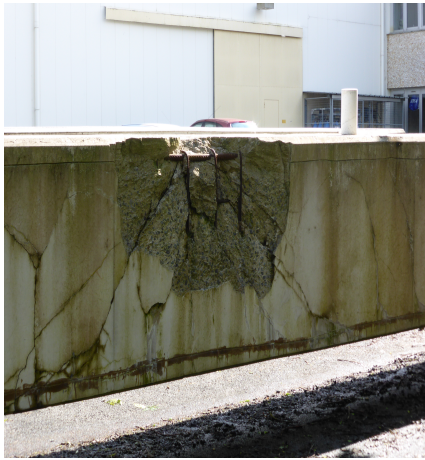
FIGURE 7.10 – Endommagement de la poutre après les différents impacts
