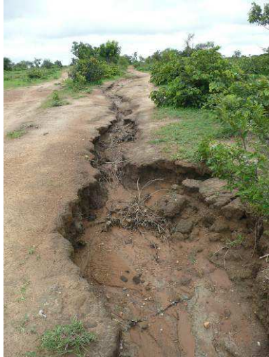
Photo 27 : Ravine entre Bagré village et la Doubégué (piste de Pata)
