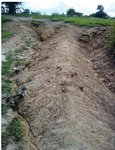
Photo 50 : Rigole observée au site de Zaba Forme en augmentation Cliché : E. Robert, 2008
