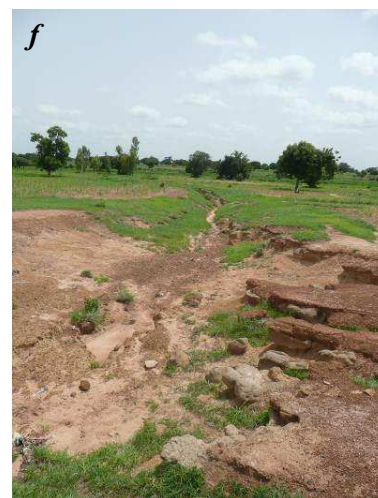
f : Zone d'érosion le long de la RN 16 Secteur fortement disséqué à la sortie de l'évacuateur
