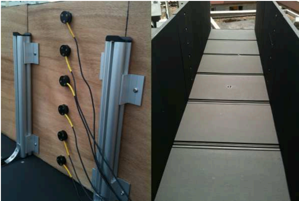
Figure III-52 : Intégration des sondes dans les façades
