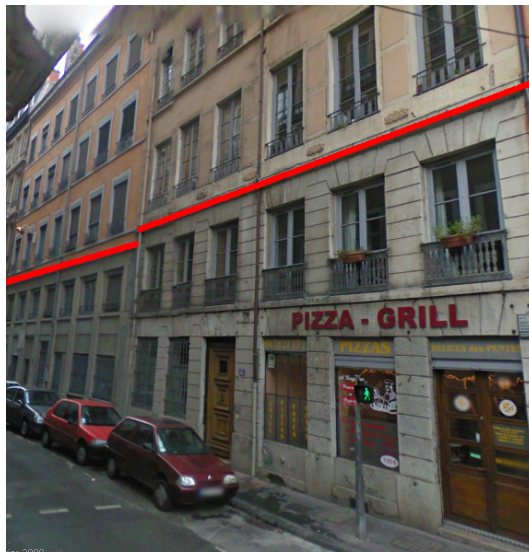
Figure III-11 : Différence de revêtement entre le bas de l'immeuble et le reste de la façade, séparés par un trait rouge
