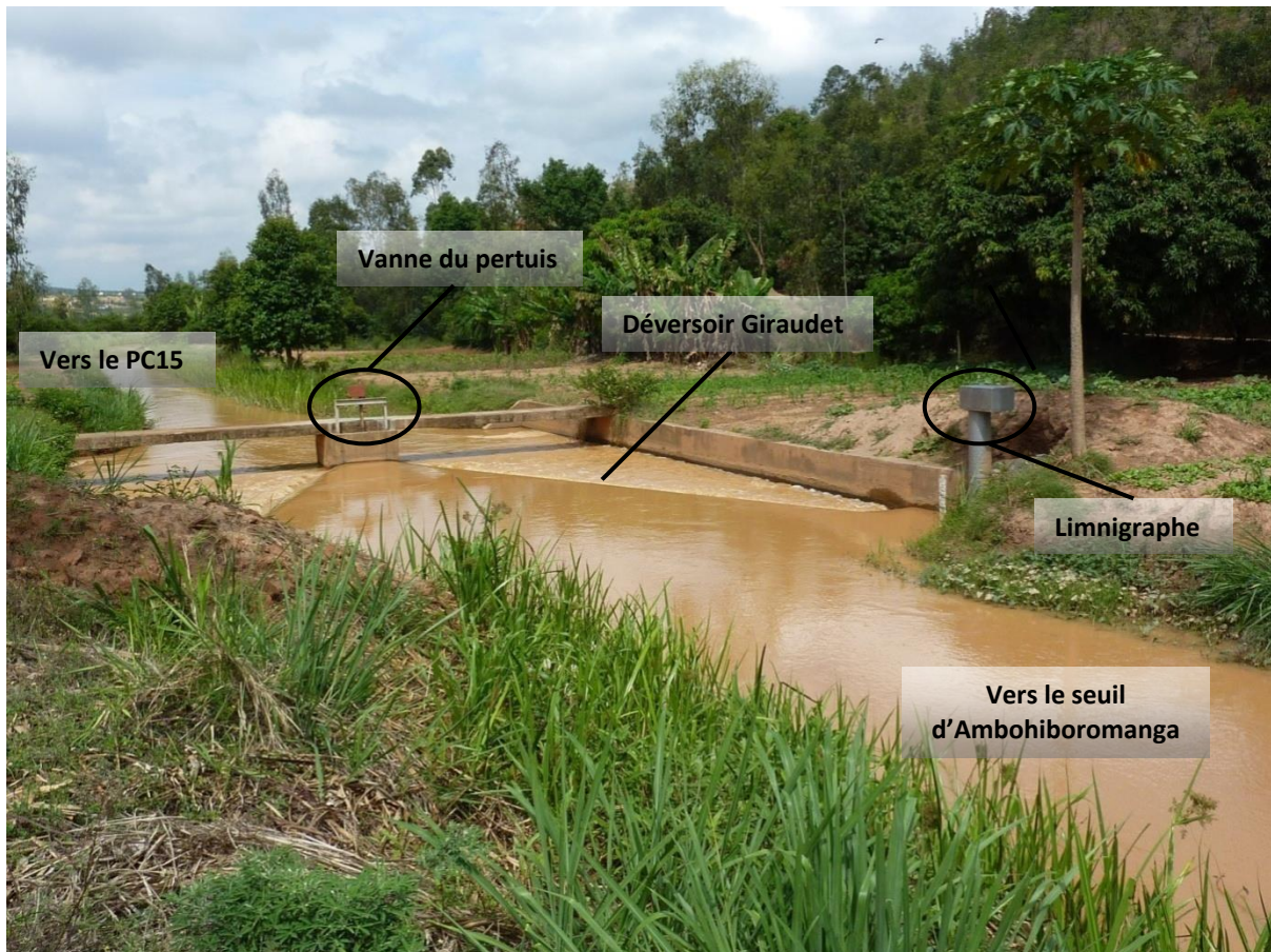
Figure 4 – Le déversoir Giraudet sur le canal de tête morte (Photo: M. Mietton).
