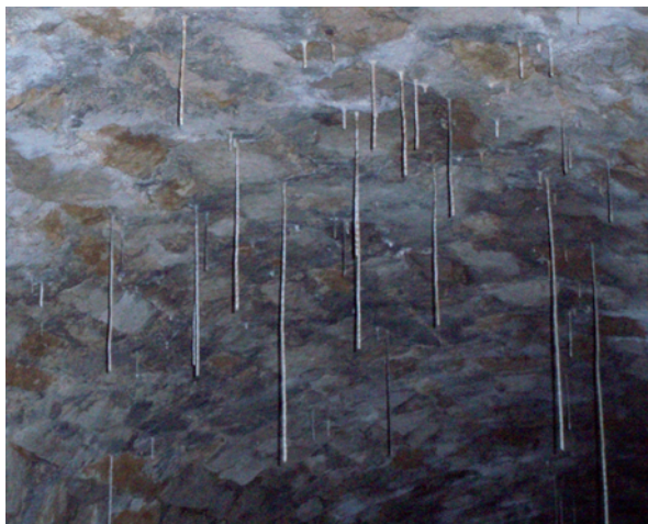
Figure 1 - Fistuleuses résultant de la carbonatation de ciment contenant de la Portlandite dans l'ancienne mine du Haut du Lièvre (Lorraine, France) - photo S. Gairoard.
