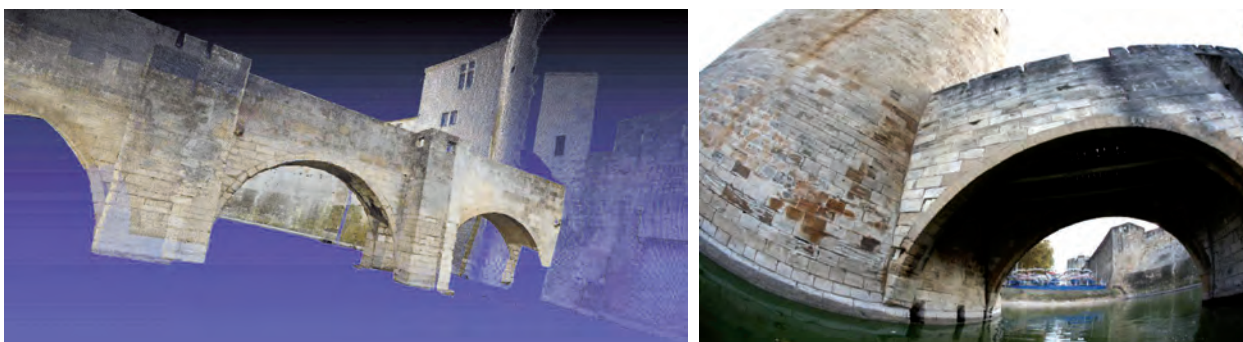
Figure 15 - Modélisation du pont de la tour de Constance à Aigues-Mortes (Gard) à partir de photos acquises depuis une barque ; à droite une des photos acquises.
