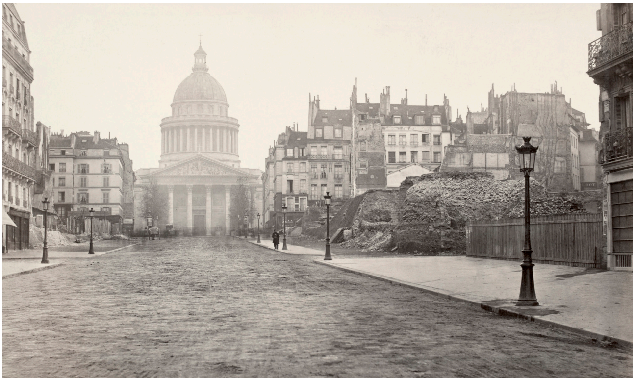
Fig. 64 : La rue Saint-Hyacinthe en cours de démolition, à droite, vers 1876-1877. Photographie de Charles Marville, Musée Carnavalet - Histoire de Paris, PH83635.
