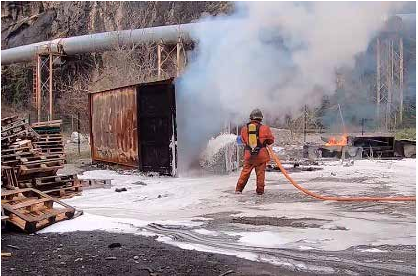
Figure 59 : Utilisation de mousse sur un feu de batterie d'environ 40kWh.
