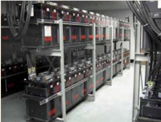
Systèmes d'alimentation de secours (industrie)
