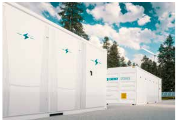
Conteneur de stockage (640-1100 V, 5,47 MWh dans container 40")
