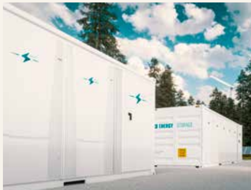
Container de stockage (640-1100 V, 6 MWh dans container 40")
