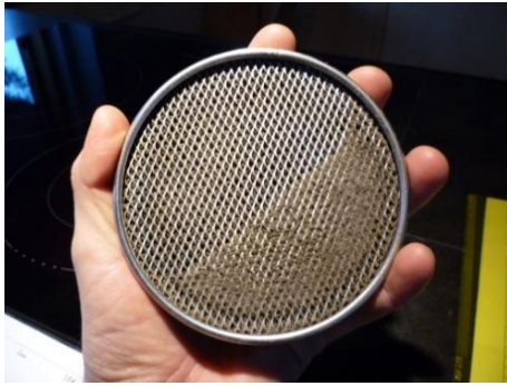
a) Filtre colmaté de la bouche d'extraction de la cuisine à moitié nettoyé
