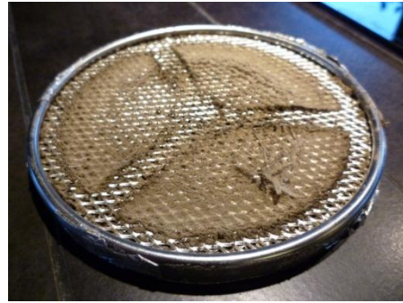
b) Filtre colmaté de la bouche d'extraction de salle de bain 2
