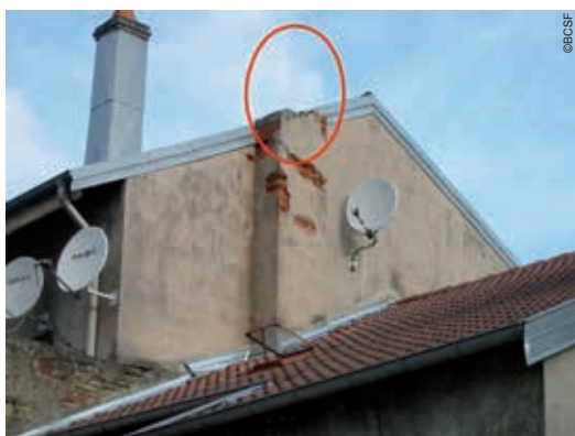
(photo 42) Rambervillers (dépt. 88) - Chute d'une cheminée non chemisée.
