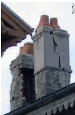
(photo 43) - Rambervillers (dépt.88) - Fissuration large et écoulement partiel de cheminées.
