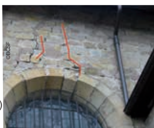
(photo 58) - Agrandissement de fissures existantes
