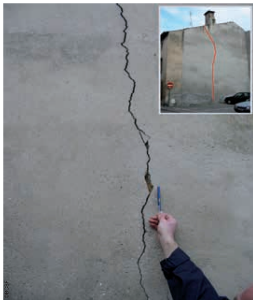
(photo 46) - Rambervillers (dépt.88)- Fissuration large, vraisemblablement due à un effet de "claquage" sur le crépis.
