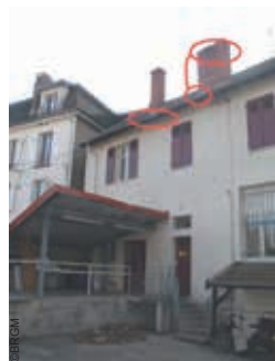
(photo 67) Baccarat (Dép.54) Endommagement de cheminées
