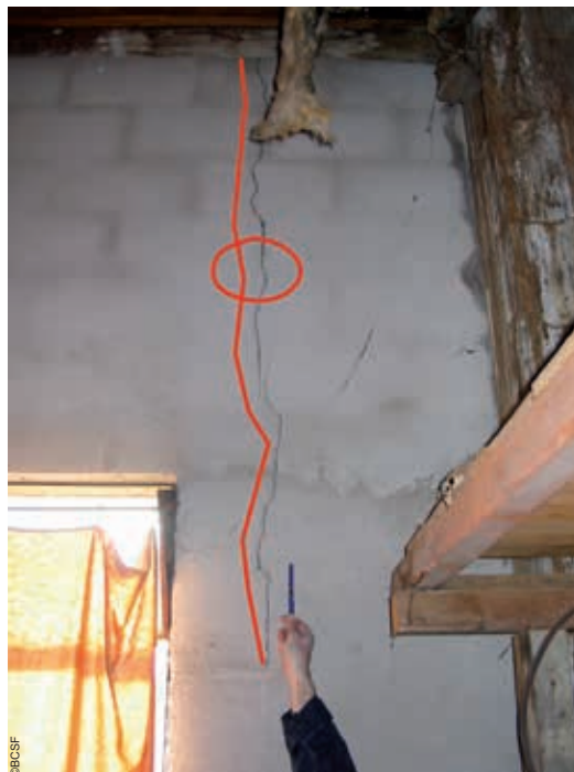
(photo 45) - Rambervillers (dépt.88) - Fissuration large de part en part d'un mur porteur en aggro.
