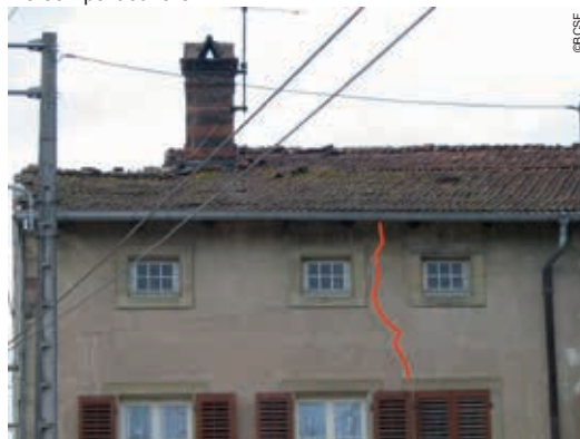
(photo 47) Rambervillers (dépt.88) - Fissuration légère sur maison particulière.
