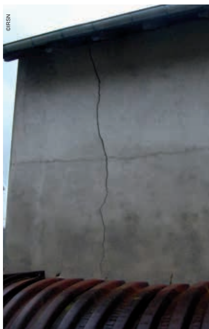
(photo 39) - Frémifontaine (dép. 88) Fissure extérieure sur bâtiment
