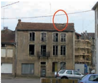
(photo 44) - Rambervillers (dépt.88)- Chute de cheminée sur bâtiment en mauvais état.
