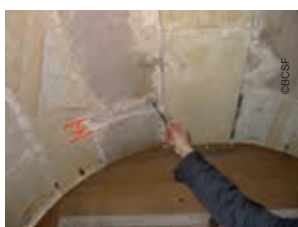
(photo 64) Affaissement d'une clef de voûte
