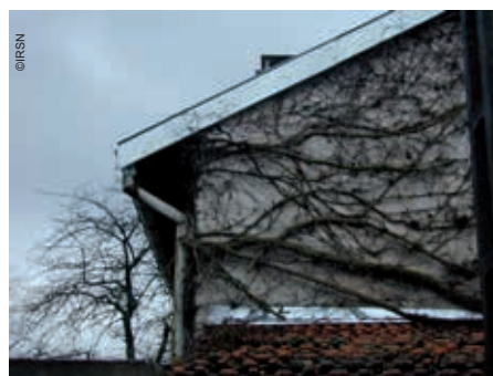
(photo 37) - Frémifontaine (dép. 88) Fissure extérieure sur bâtiment
