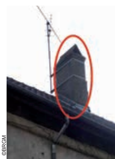
(photo 62) Désordre de cheminée
