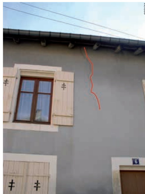
(photo 73) Fissuration large sur mur extérieur
