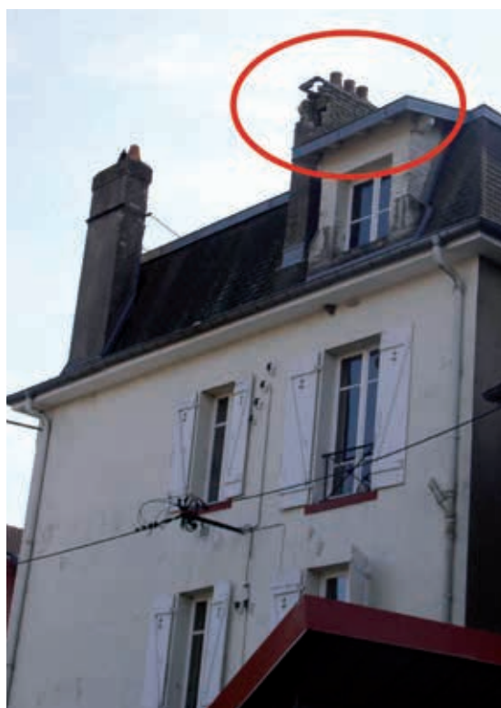
(photo 74) Désordre sur cheminée.
