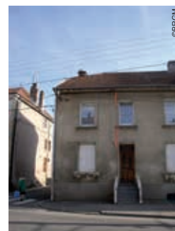
(photo 69) Fissuration fine sur mur extérieur
