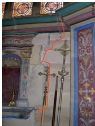
(photo 51) - Large agrandissement d'une fissure derrière l'autel.
