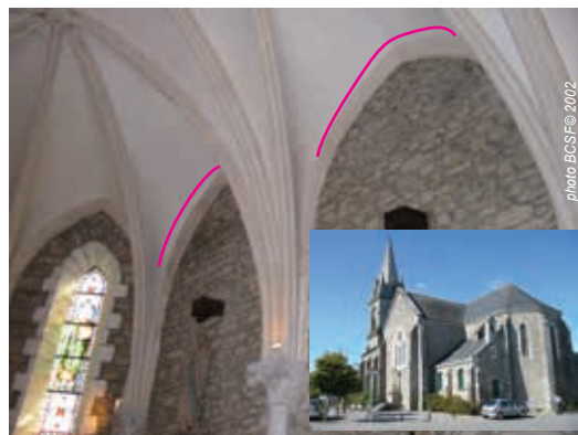
[fig. 84] - fissures sur arc de voûte (église de Grand-Champ)
