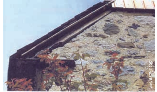
[fig. 59] - Désolidarisation du toit et du mur en maçonnerie d'une vieille maison attenante à l'église de Salles-Argeles
