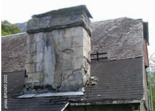
[fig. 58] - Cheminée ébranlée à l'entrée de Caunterets
