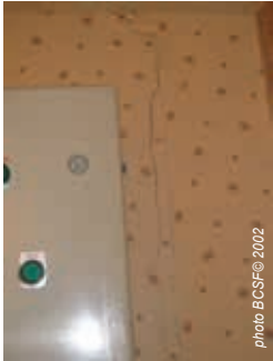
[fig. 79] - fissure intérieure (Kerhen-Liven, Languidic)
