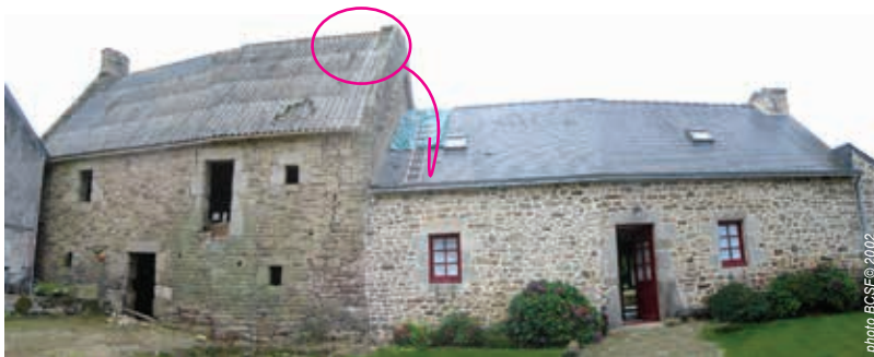
[fig. 80] - cheminée cassée au ras du toit (Kerhen-Liven, Languidic).
