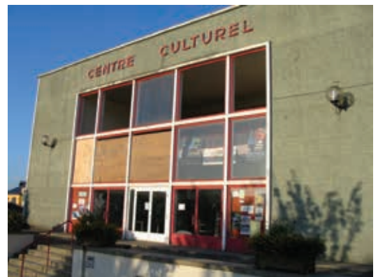
[fig. 77] - Vitres cassées - façade est (Inzinzac-Lochrist, Centre socio-culturel).
