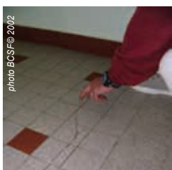
[fig. 83] - Fissures sur sol et murs (Lycée Colbert - Lorient)
