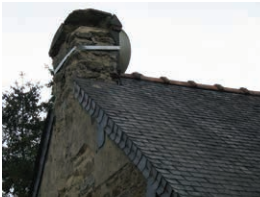
[fig. 75] - Chute d'une partie de couronne de cheminée (Hennebont, rue du Meunier).
