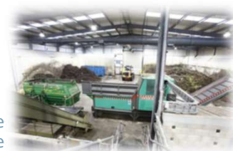
Installation de Rochdale
