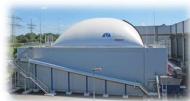
Digester de l'unité de méthanisation
