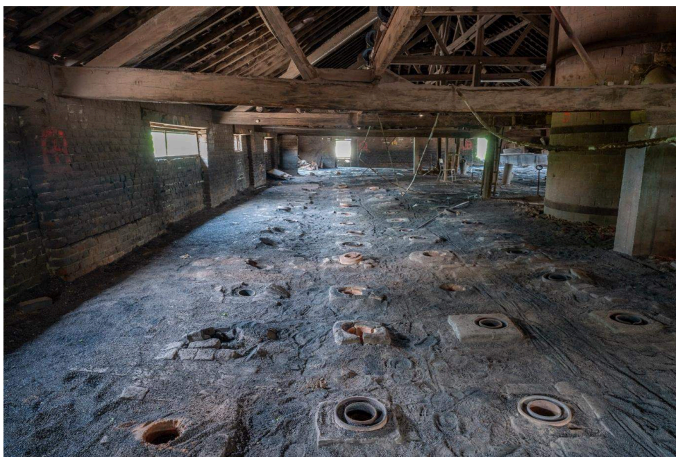
Fig.4. Galerie supérieure du four Hoffmann
