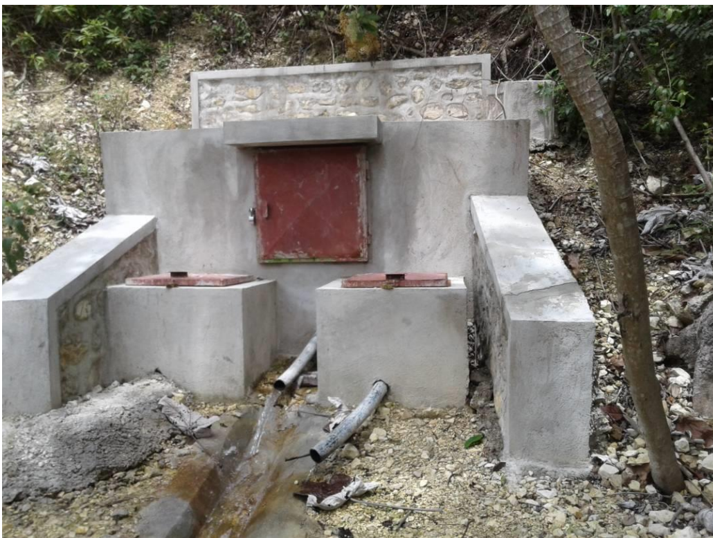
Figure 11 : la source aménagée « la ferme » sur les hauteurs de Grande Plaine (crédit photo CEFREPADE)
