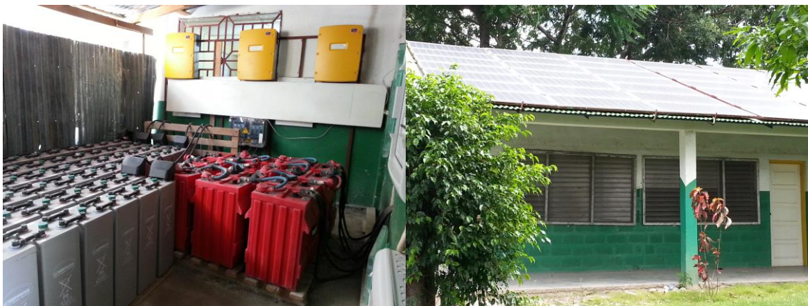
Figures 7a et 7b : l'équipement électrique photovoltaïque de l'hôpital HAM (crédit photo CEFREPADE)
