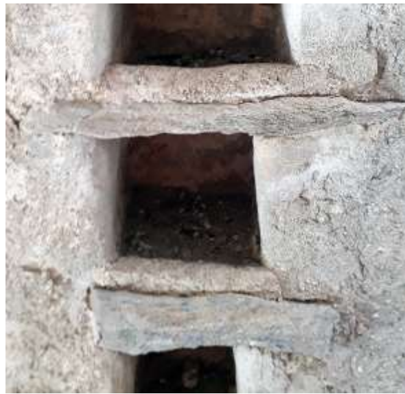
Fig. 12 : Bourelet de plâtre
