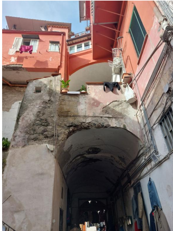
Figure 5. la densification-verticalisation du bâti : fripes et dégradation urbaine au rez-de-chaussée / habitations modernes à l'étage (février 2024, S. Le Bihan)
