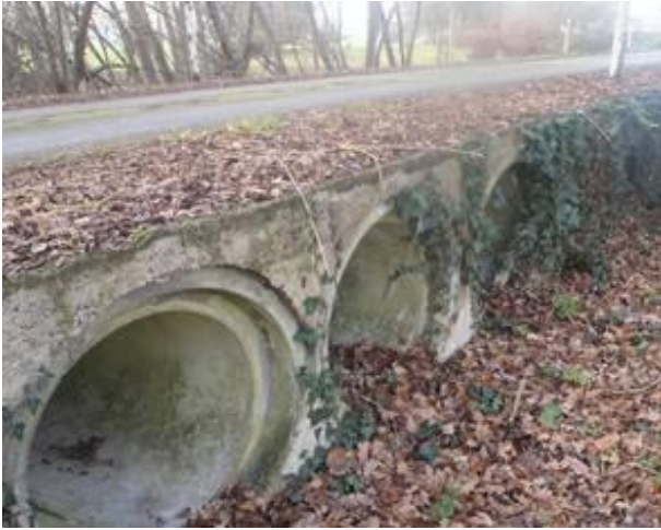
Déversoirs à buse
