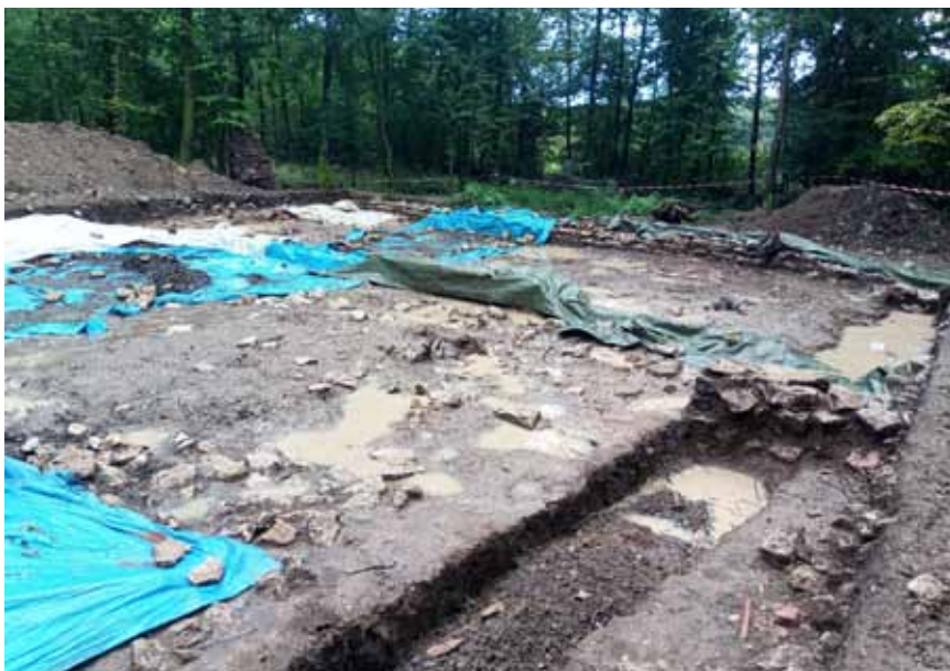
Fig. 5 État du chantier après le passage d'un bref mais violent orage
