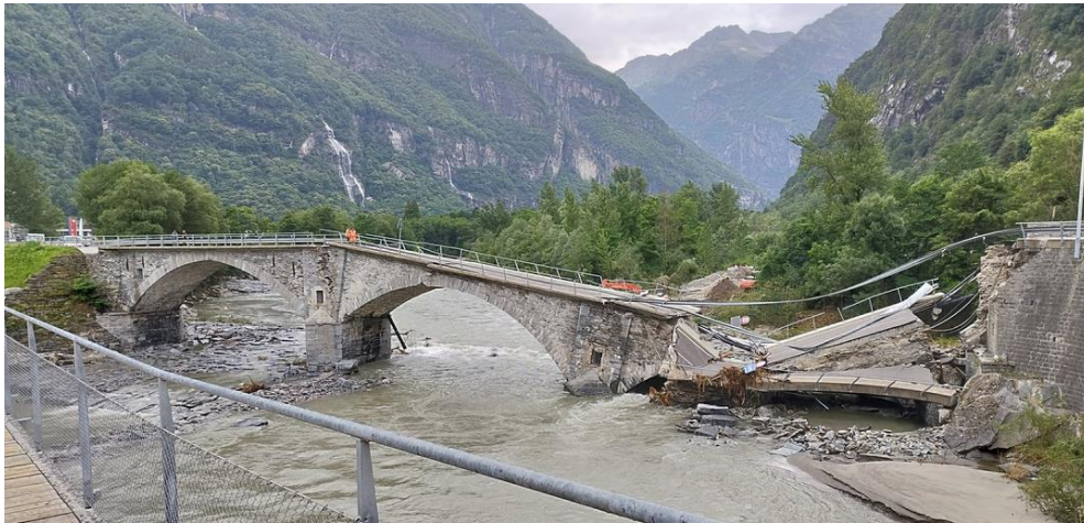
Figure 4: Destruction du pont de la route cantonale à Cevio dans le haut Val Maggia (source : compte X Julien Guillaume).
