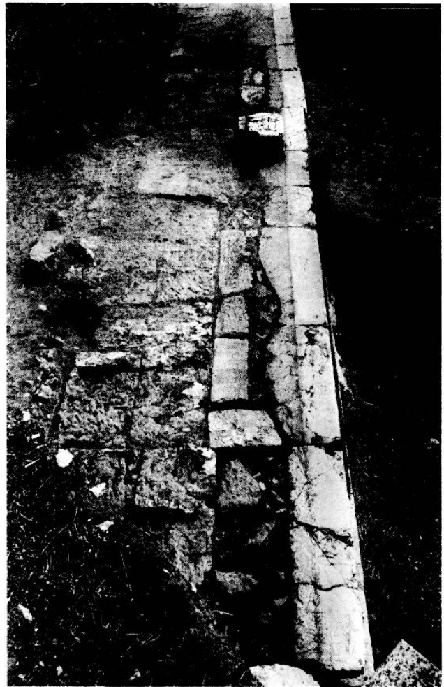
Fig. 9. Fondations en poros de la krépis K, en AN 74-75 (vues vers l'ENE).
