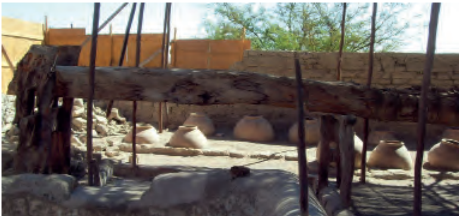
Fig. 155. Lagar de Matilla. Monumento Nacional. Aquí se verificó, en el año 1929, la última pisa de la uva proveniente de las viñas de la quebrada de Quisma. Este lagar, hoy semiderruido tras el terremoto de junio del año 2005, no ha sido reconstruido aún. Es el testimonio viviente de una época de prosperidad para los cultivadores de la vid ( Vitis vinifera ), tanto en Pica como en Matilla. Hubo aquí, en efecto, durante los siglos xvii al xix centenares de chacras o predios dedicados a este cultivo preferente. Aquí se pueden ver hoy las grandes tinajas del siglo xviii donde se guardaba el vino hasta su fermentación. Estas muestran los nombres propios de las chacras de origen, todas con sugestivas denominaciones de santos de la Iglesia: Santa Lucía, San Pedro, San Francisco, San Agustín, o advocaciones diversas de la virgen María. Son testigos fieles de una época de profunda religiosidad. El lugar es un valioso hito patrimonial de visita obligada para el viajero que hoy llega a Matilla a husmear los "recuerdos del pasado" (foto de Horacio Larrain, abril de 2010).
