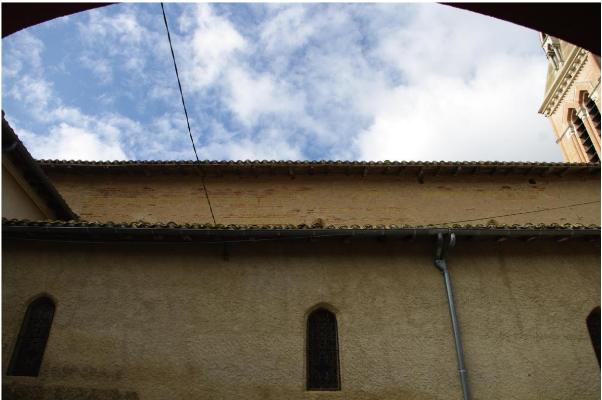
Fig. 16 : Monferran-Savès, église paroissiale, élévation nord de l'église, vue partielle (Cl. C. Balagna)
