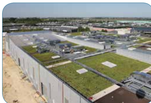
Chaix et Morel Architectes - Vue de la toiture - (photo de chantier) © TRIBU
