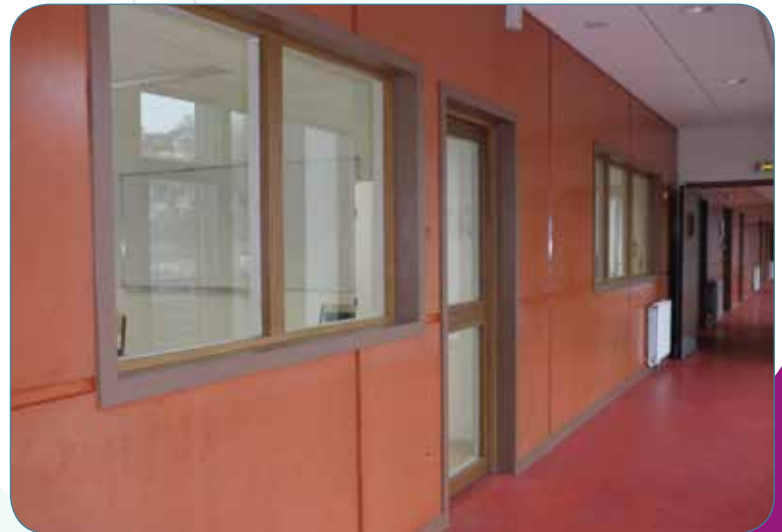
Apport de lumière naturelle par second jour (Lycée Robert Schuman à Charenton © Brindel-Beth. Architecte : EPICURIA et MALISAN)
