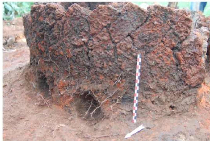
Figure 26 : Paroi de la cheminée du four BIT01 constituée de brique rectangulaire agencée selon un motif en « arête de poisson »
