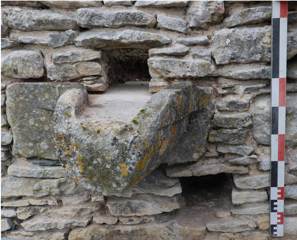
Figure 2. Vue d'une gargouille et d'un trou de boulin entre les contreforts C 8 et C 9 (© Inrap, Nicolas Holzem)
