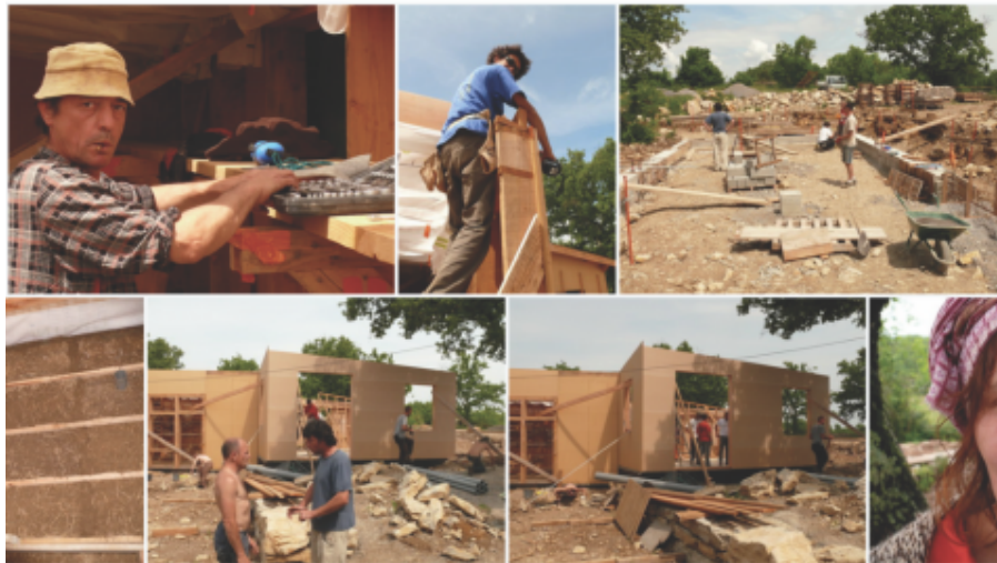
Figure 12. Construction du Hameau des Buis (2006-2011), chantier participatif suivi par l'architecte Pierre-Louis Gomez
