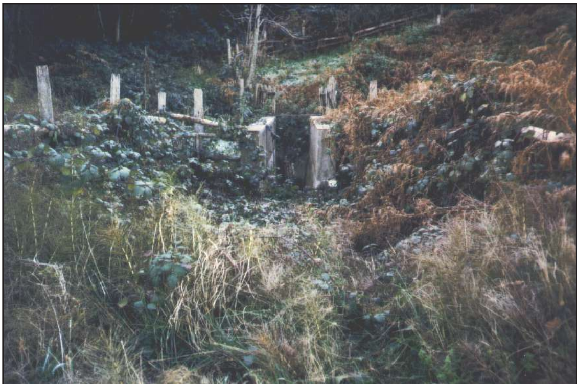
Photo 13 : L'installation (20/11/98). La construction est en bon état, mais la végétation a pris possession de l'installation suite à la diminution de la fréquence des bains.
