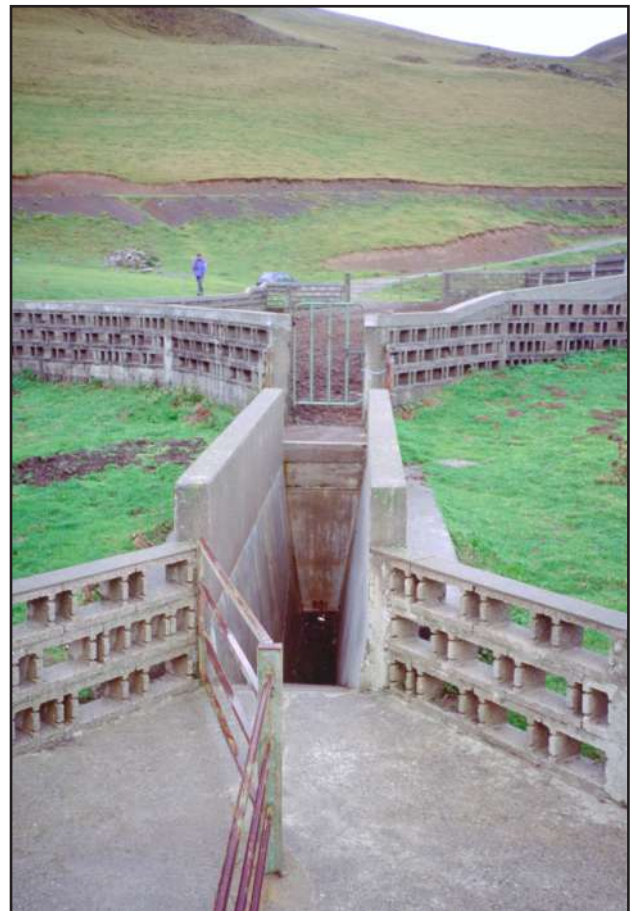
Photo 16 : Malgré une faible utilisation, les installations sont en bon état.
