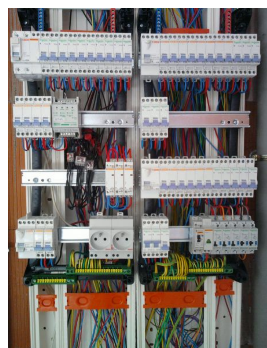
Une armoire électrique avec des départs à mesurer (il faut un peu de place sous chaque départ)
