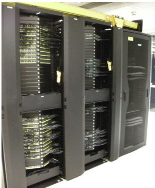
Figure 1 - Armoires de prébrassage et goulotte optique
