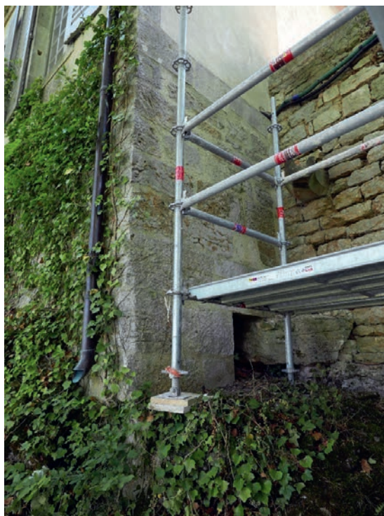
UM8 : trou dans l'épaisseur du mur du Cabinet d'étude
