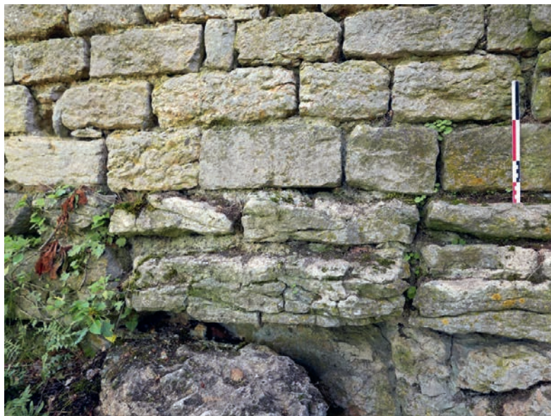
SRA11, UM1 : semelle de fondation composée de roche délitée, maçonnée à l'aide de mortier de chaux : l'élévation est posée légèrement en retrait sur cette fondation
