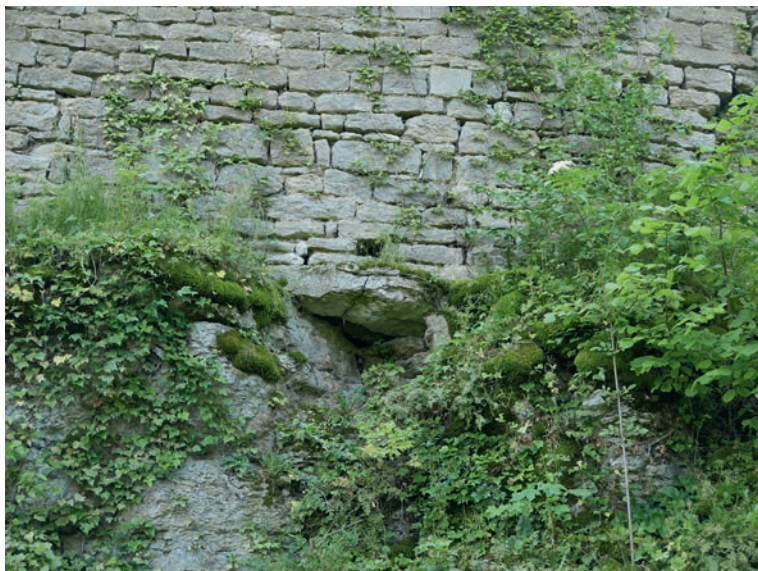
ill. 8 : Détail des maçonneries du mur UM 1, qui reposent sur une dalle intermédiaire permettant d'enjamber une faille.
