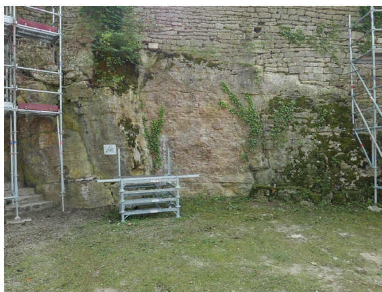
ill. 17 : Le rocher naturel au SUD de la poterne présente des litages qui facilitent l'extraction des blocs pour la préparation des fondations.
