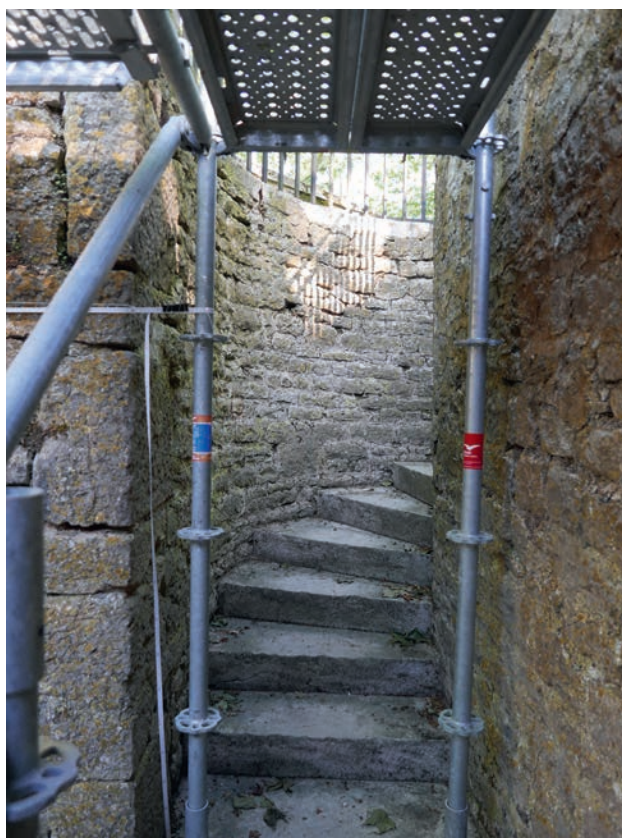
ill. 23 : Escalier de la poterne en partie haute, vu depuis l'est (à gauche du cliché l'UM 12, à droite l'UM 11).
