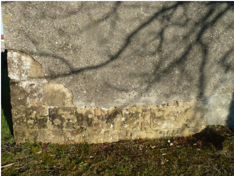
Fig. 32 : Église de Bastanous, élévation du mur ouest, détail de l'angle nord-ouest (Cl. C. Balagna)
