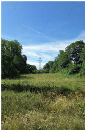
Figure 2 : Lignes électriques aériennes surplombant la clairière de pelouse à fétuque à Saint-Pryvé-Saint-Mesmin, Département du Loiret (Coordonnées géographiques : 47°51'52.1"N+1°48'27.7"E).
