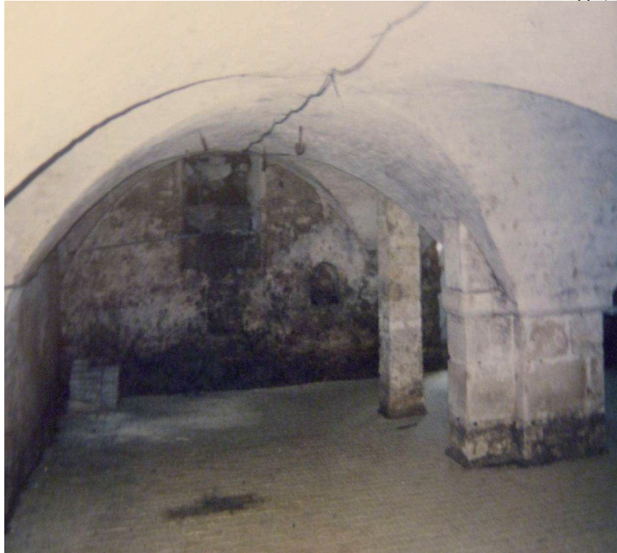
ill. 9 - Salle voûtée, peut-être ancien cellier des moines, rue du Prieuré (cl. Michel Philippe) :
