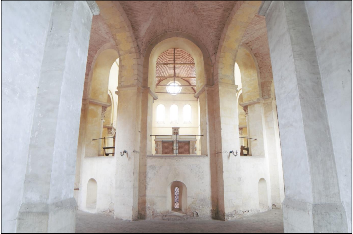
Figure 9- Vue vers le déambulatoire et l'abside, avec les ouvertures de la crypte, depuis la chapelle axiale. © E. Chargé.
