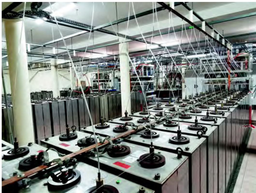
Bancs de condensateurs du LNCMI. © Oliver PORTUGALL
