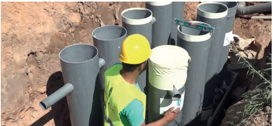
Installation du démonstrateur pour le traitement des eaux usées à Tinghir
