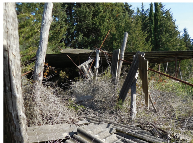
fig.4 : sur la colline nord, les toitures dégradées et la végétation (Kewin Peche-Quilicchini, Inrap 2017).
