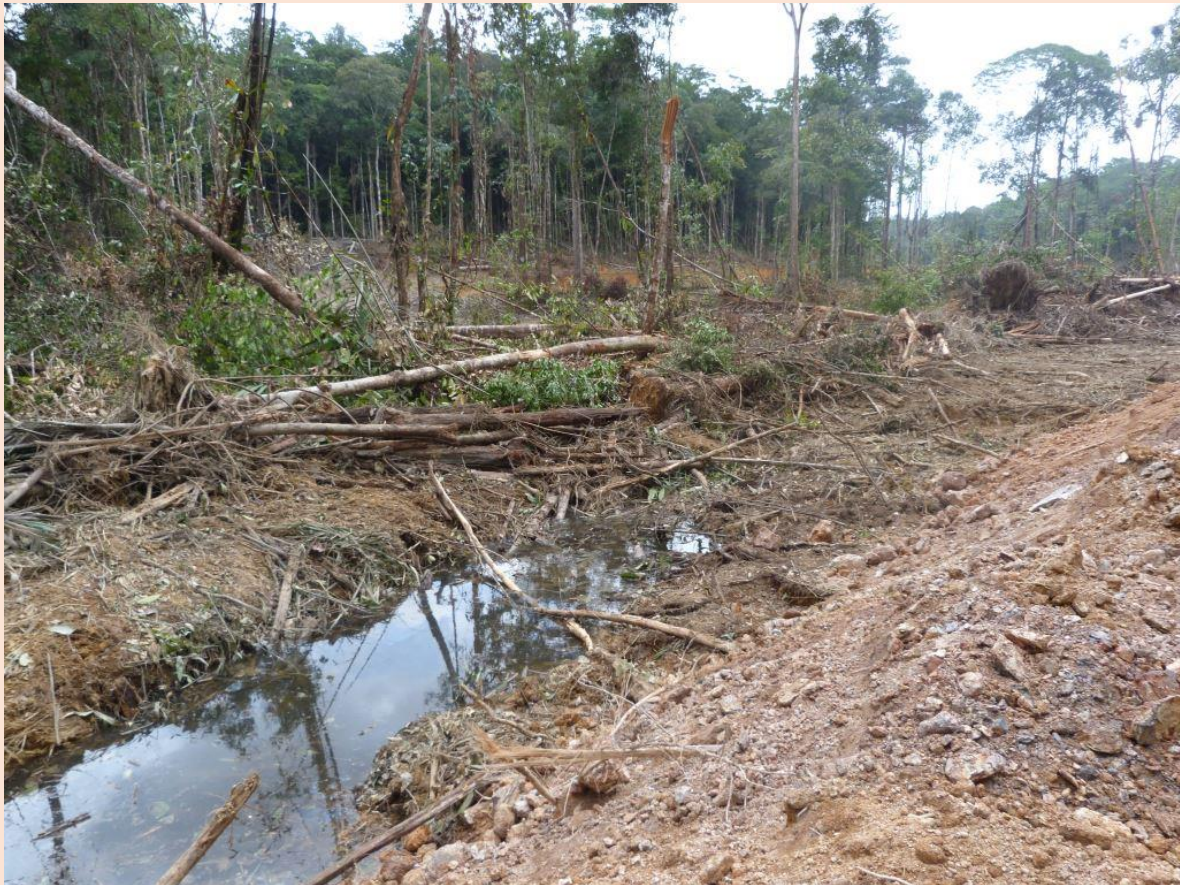
Figure 5 : Exemple de perturbation sur l'extrémité amont d'une AEX : les opérations de défrichage ont conduit à l'obstruction de la crique et à la perturbation du bon écoulement des eaux, influençant la morphologie du lit, y compris dans la zone non exploitée.
