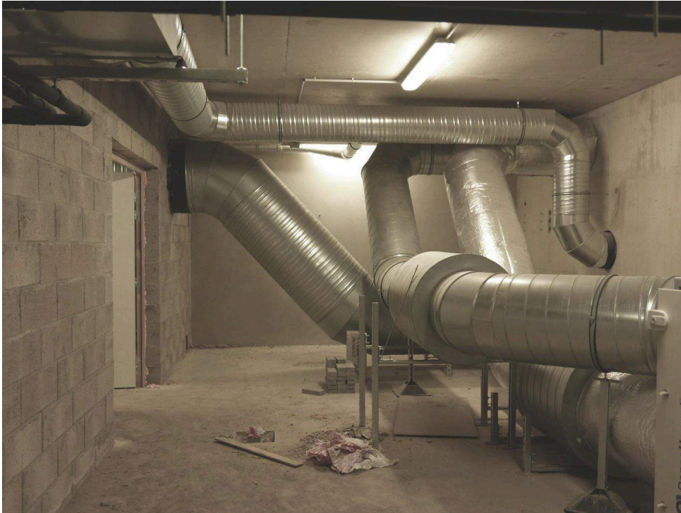
Figure 3. Intérieur d'un local de traitement d'air dans lequel un ensemble de gaines se contorsionne pour rejoindre les différents espaces à conditionner
