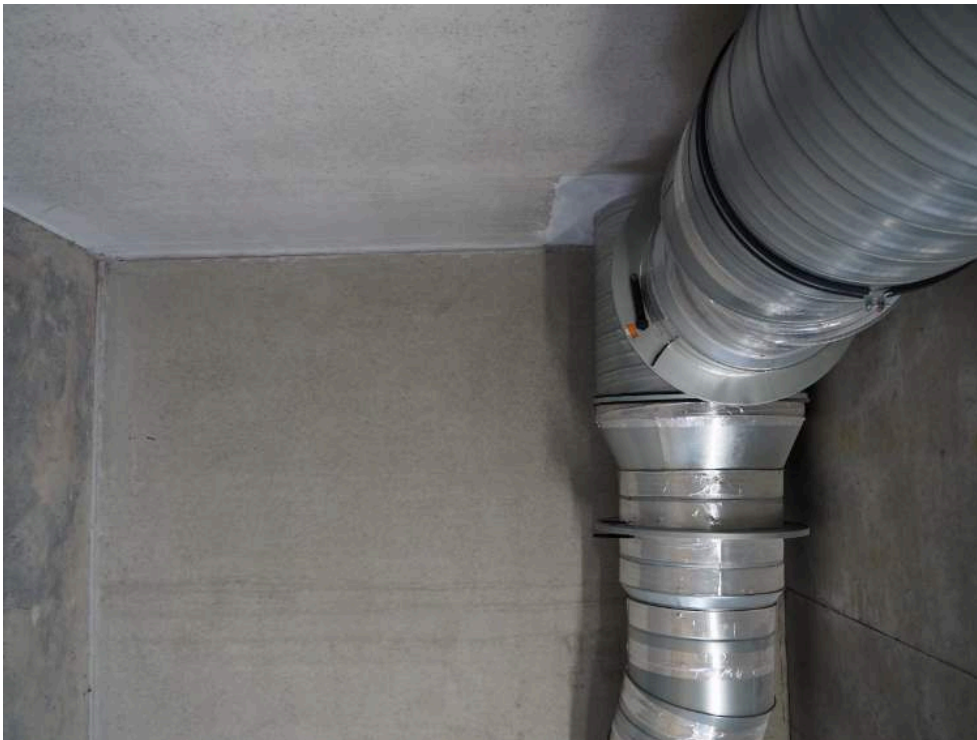
Figure 6. Aperçu d'un tronçon de gaine qui présente des adaptations de sections, des contorsions, des raccords, réalisés par divers joints, scotchs ou profils métalliques.
