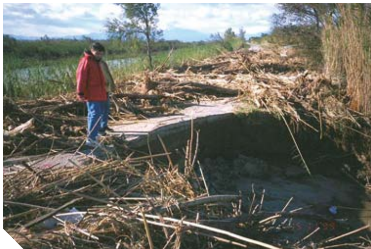
Dégâts dus à la surverse d'une digue lors de la crue des 12-13/11/1999 : importante loupe d'érosion et de glissement dans le talus aval (© E. Josse DDE 66).
