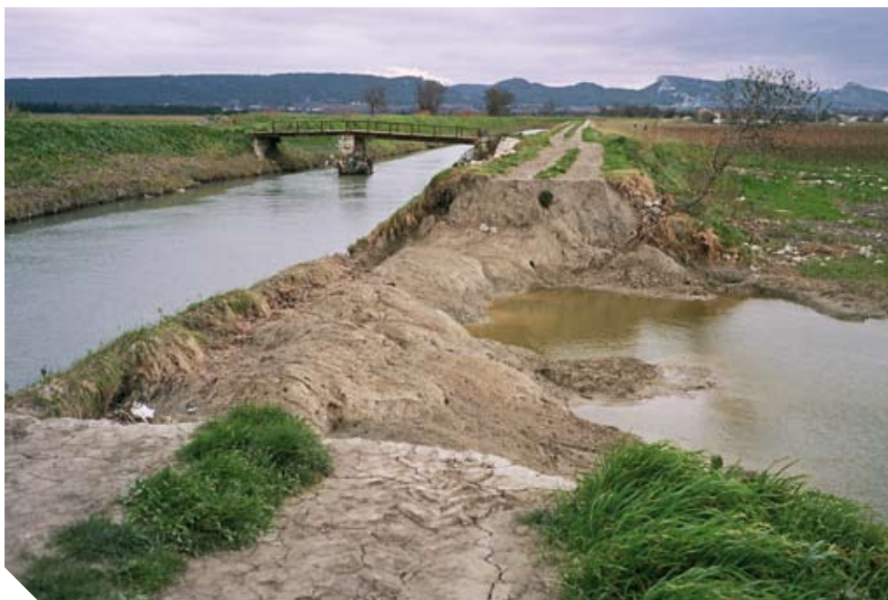
La digue de Vigueirat dégradée par une crue (© M. Provansal)
