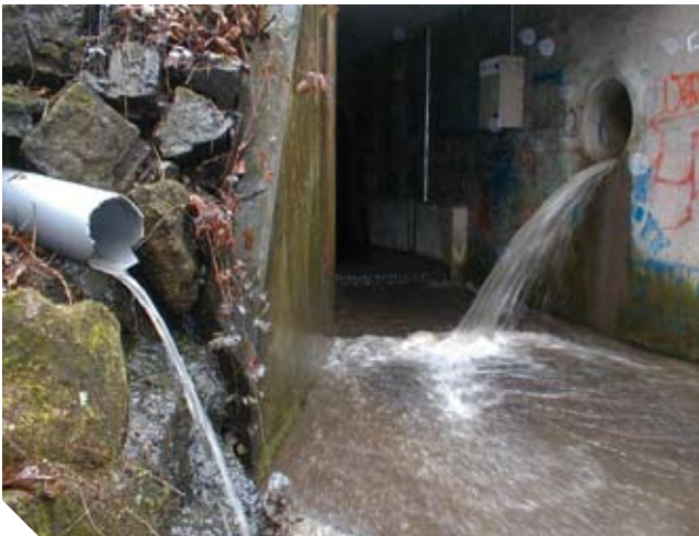
Déversoir d'orage de Grézieux-la-Varenne - 69 (© Cemagref)
