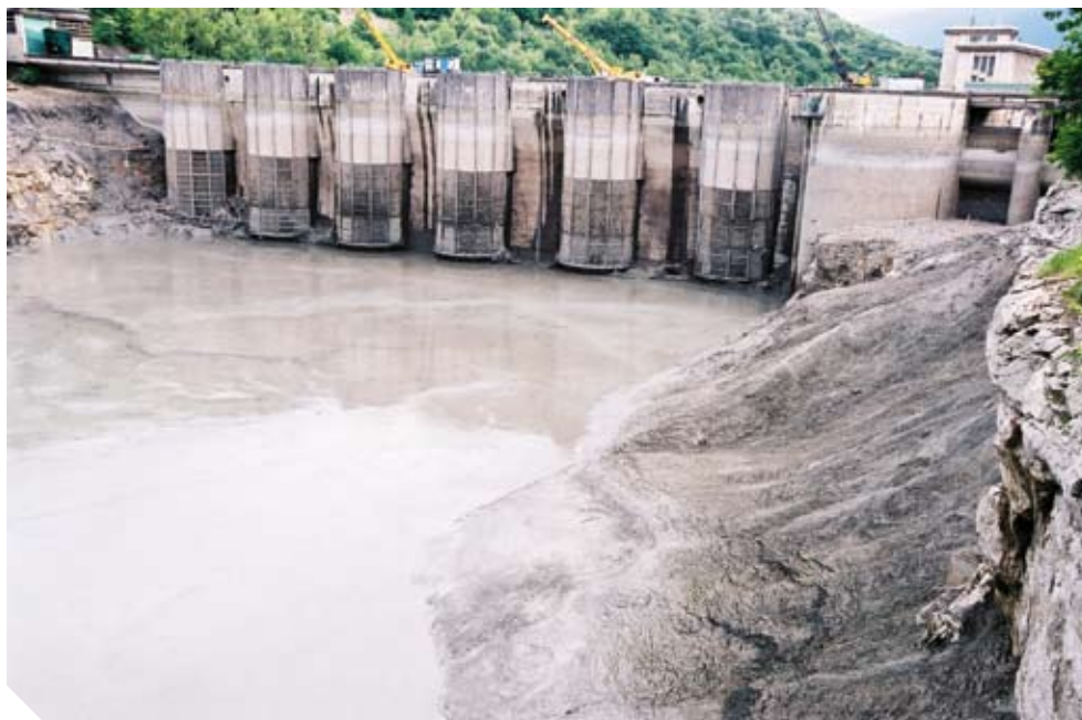
Le barrage de Génissiat (vue sur les prises d'eau amont) pendant une chasse (© Photothèque CNR).
