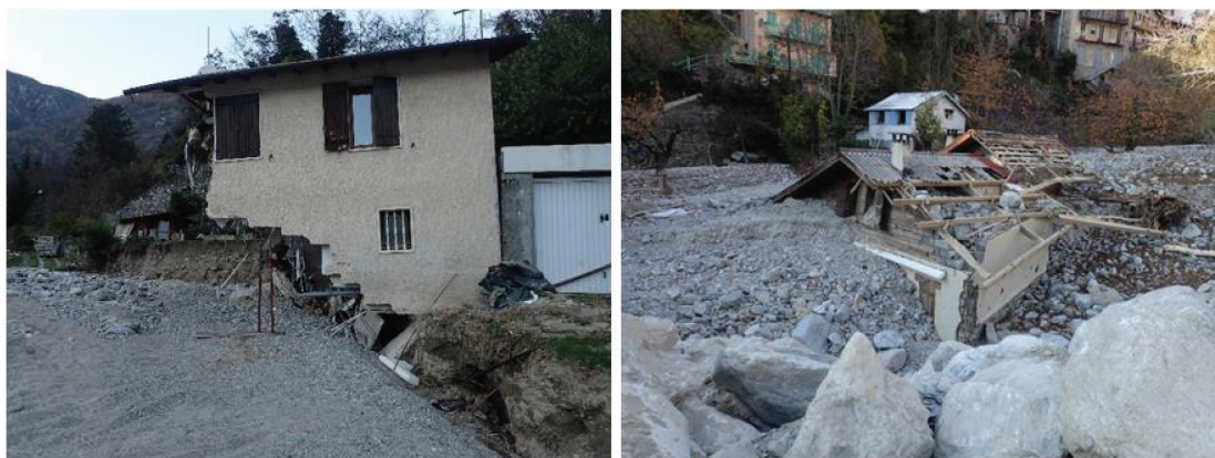
Figure 6. Exemple d'état de bâtis levé pendant le terrain post évènement : (gauche) St Dalmas de Tende, dommage important par affouillement d'intensité forte, y compris localement au niveau des fondations (source : ONF-RTM) ; (droite) St Martin Vésubie, dommages importants par engrèvement d'intensité forte sans affouillement des fondations (source : ONF-RTM).
