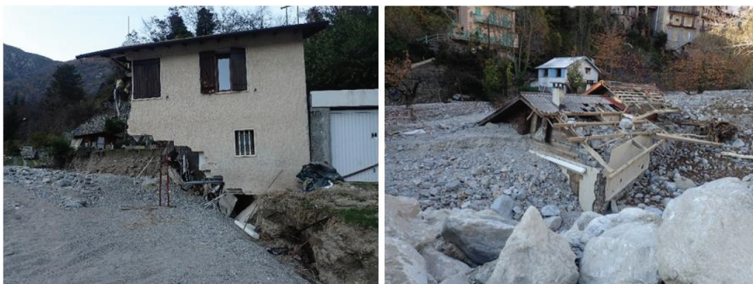
Figure 6. Exemple d'état de bâtis levé pendant le terrain post évènement : (gauche) St Dalmas de Tende, dommage important par affouillement d'intensité forte, y compris localement au niveau des fondations (source : ONF-RTM) ; (droite) St Martin Vésubie, dommages importants par engrèvement d'intensité forte sans affouillement des fondations (source : ONF-RTM).
