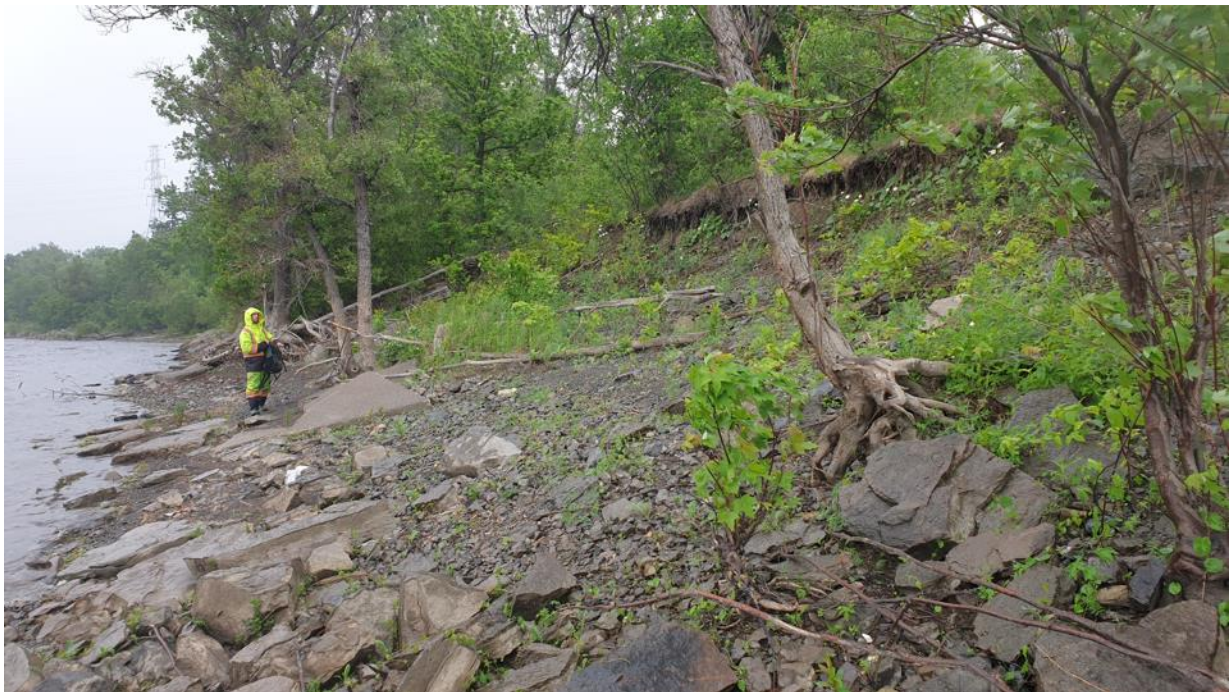
Figure 35 Tronçon 1129 vue des berges fortement érodées jusque dans leur partie supérieure, dans le parc du Bois-de-Liesse.
