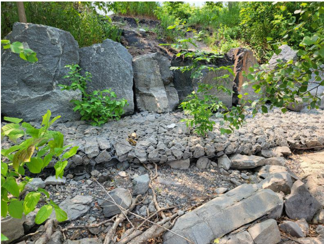
Figure 17 Tronçon 1028 du parc Promenade-Bellerive stabilisé par des gabions en bas de talus et des gros blocs de roches alignés au-dessus.
