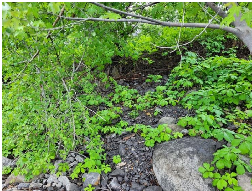
Figure 25 Partie haute du talus fortement érodée pour le tronçon 1079, secteur de l'accueil du parc du Cap-Saint-Jacques.
